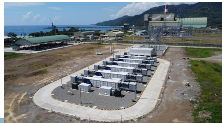
20 MW 20 MWh (Philippines)
