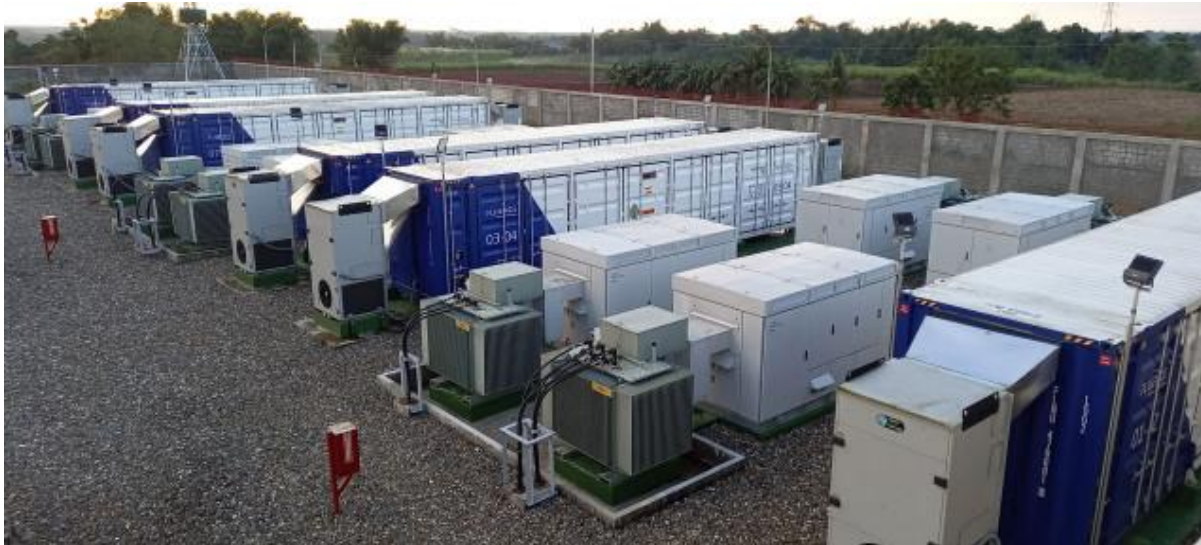
20 MW 20 MWh (Philippines)
